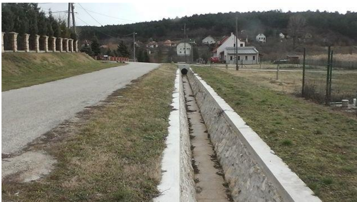
6. kép: A Patak utcai burkolat nyílt árok
